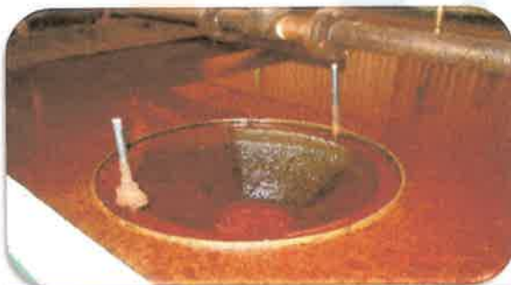
เข้าระบบทำความสะอาดน้ำมัน
